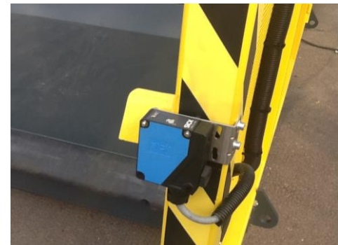
• Barrière immatérielle de sécurité
