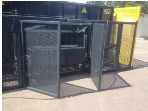
• Portes arrières sécurisées accès local maintenance
