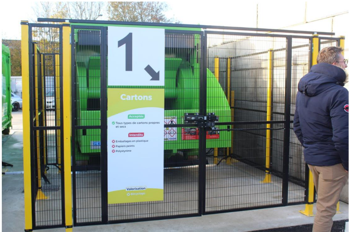
Deux compacteurs ont été installés : un pour le carton, un autre pour les métaux.
