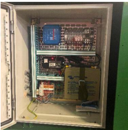
Armoire électrique incluant une batterie d'alimentation
