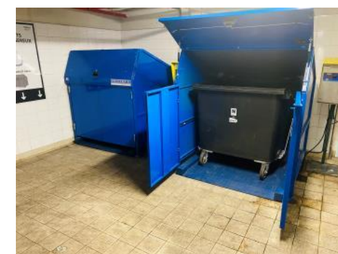
Cache bac avec contrôle d'accès et pesée
