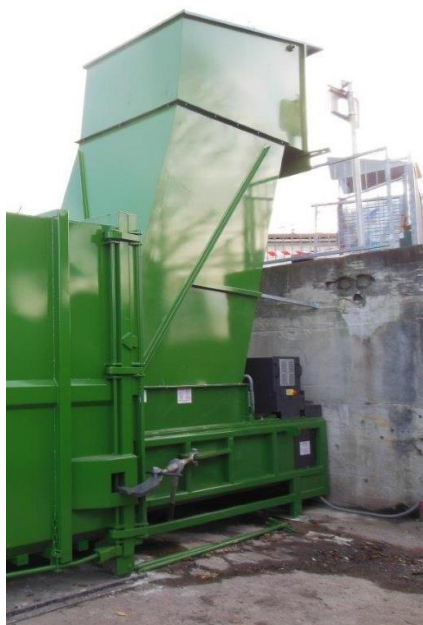
• i3- 2000 trémie à quai frontale
