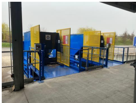
• LC sur plateforme et commandes à distance
