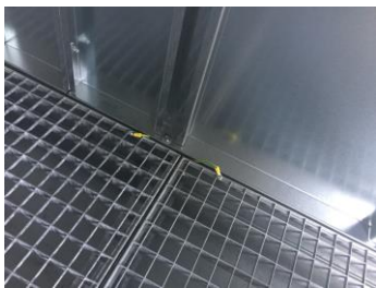
Plancher bac de rétention
