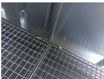
Plancher bac de rétention
