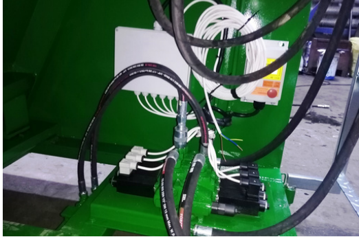
Armoire électrique et distributeur hydraulique
