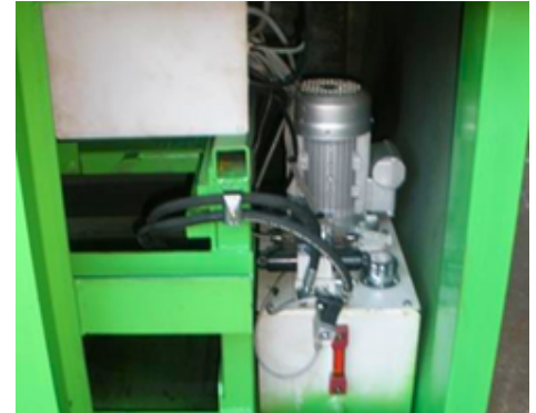
Armoire électrique et centrale hydraulique
