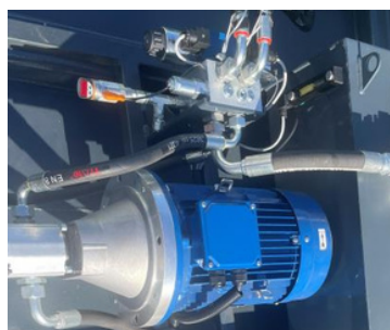
Centrale hydraulique et armoire électrique sur le toit
